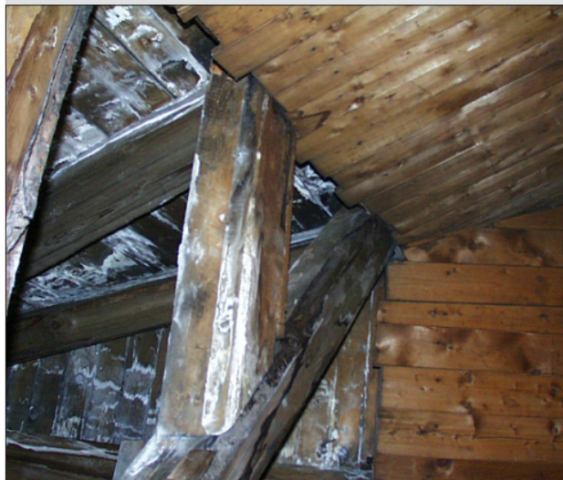
Saltutslag på trematerialer.
