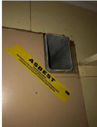
Ventilasjonskanal inneholder asbest
