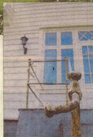
FORFALLETS SKJØNNHET?: Smijernet på trappen er det eneste som ikke er i tipp topp stand på presteboligen i Klokkarvik. Spørsmålet er om det i det hele tatt trengs å fikses.
