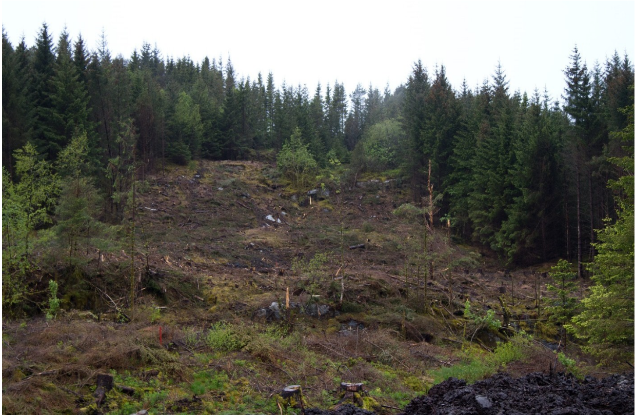
Skogryddingstrasé vest for landtaket i Saltvika. Vegetasjon er bevart i horisonten noe som vil dempe landskapsvirkningen av ledningstraséen på en god måte.
