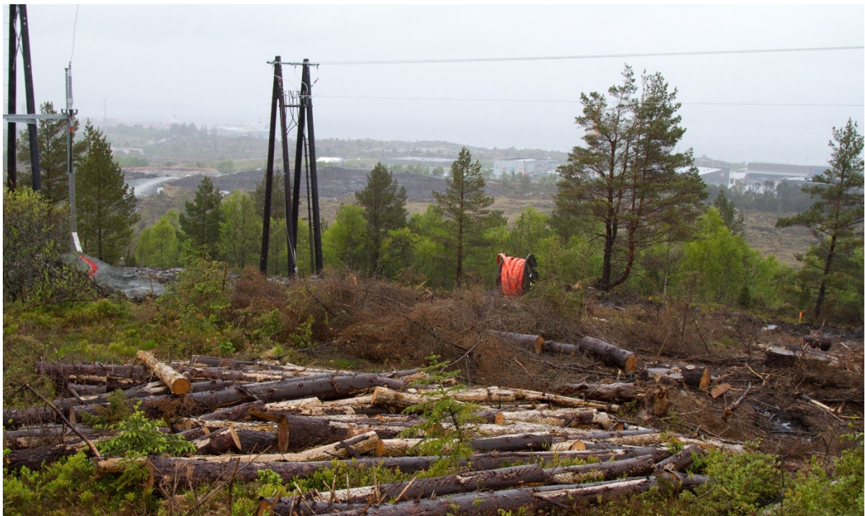
Det ligger igjen noe hogstavfall ved endemast sør for stasjonsområdet som skal fjernes.
