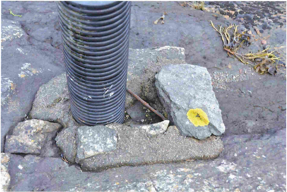
Opprinnelig støttefundament med lav som viser alderen. Viser også en sterkt korrodert jernmering som bekrefter alderen til fundamentet. Posisjon D.
