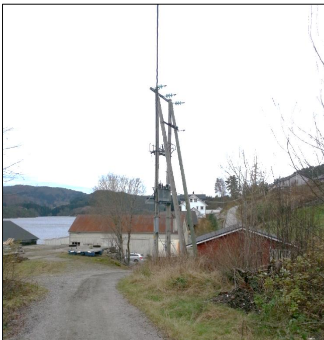
Figur 20: Mastetrafo i området.
