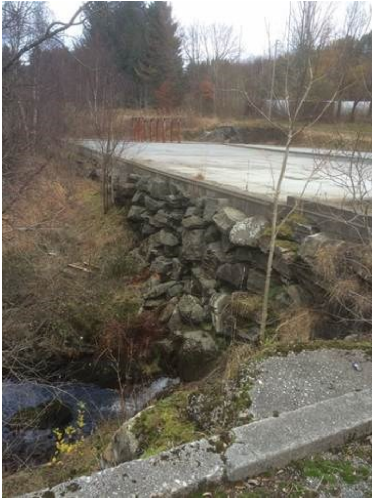
Figur 2 Innløp kulvert ved myra nord for fylkesvegen (bilde tv) og utløp kulvert som går under fylkesvegen t(bilde i midten). Det siste bilde viser utløp vest for planområdet.
