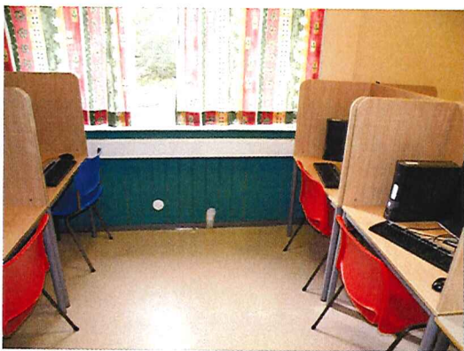
Foto 5. Datarom. Brystningspanel på ytterveggen. Ingen tegn til oppfukning eller soppvekst på baksiden av dette, kontrollert gjennom to hull.
