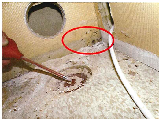
Foto 2. Skolekjøkkenet, delevegg mot naturfagsalen og med den lille delevveggen til høyre. Lokal vekst av muggsopp nederst på delevveggen mot naturfag (rød ring). Tydelig trekk ned i gulvkonstruksjonen.
