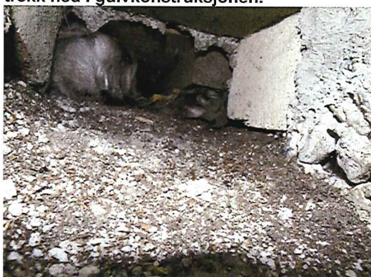
Foto 4. Inn i gulvkonstruksjonen via utvendig luke. Analyse av medbrakt prøver viser vekst av muggsopp på materialene.
