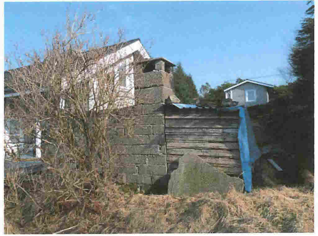
Mur og skorstein sett fra vest. Både mur og vedskjul er i dårlig forfatning.
