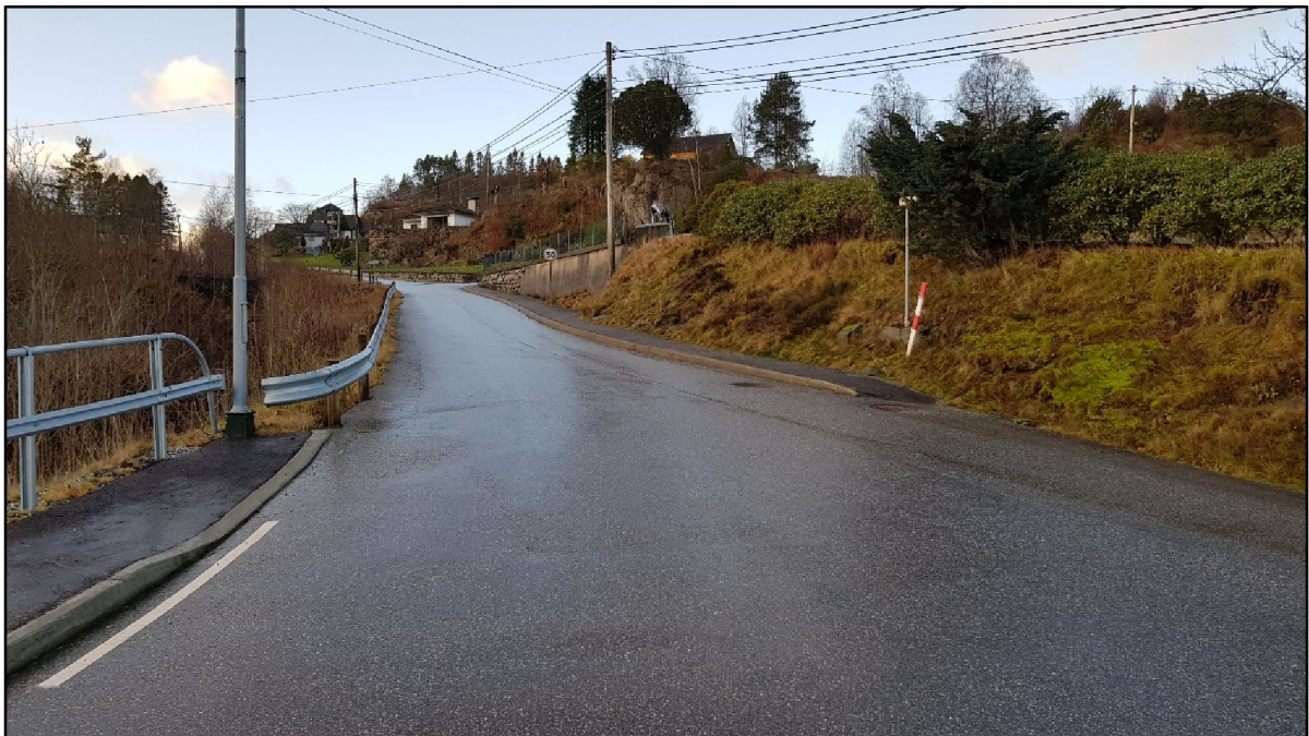
Figur 8: Den kommunale vegen Fosse, sett frå Fossekrysset. Nytt gangvegssystem er kopla på eksisterande fortau langs vegen Fosse. Kryssingspunkt i vegen Fosse med nedsenka kantstein. (Foto frå desember 2018)
