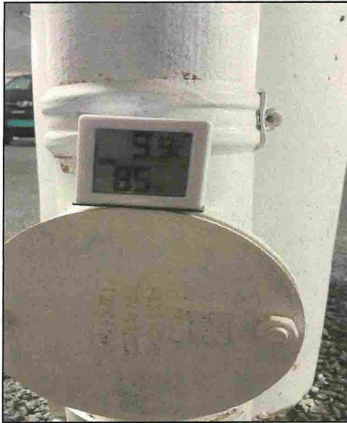
Bilde 1. Luftfuktighet og temp. i garasje 68.
