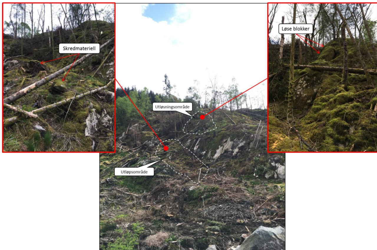
Figur 8. Foto fra befarig. Bildet i senter, viser området hvor det er registrert løse blokker og området hvor det er registrert skredmaterieill. Bildet oppe til venstre viser blokker som har falt ut fra skråningen (historiske skredhendelser). Bildet oppe til høyre viser området hvor det er registrert løse blokker.
