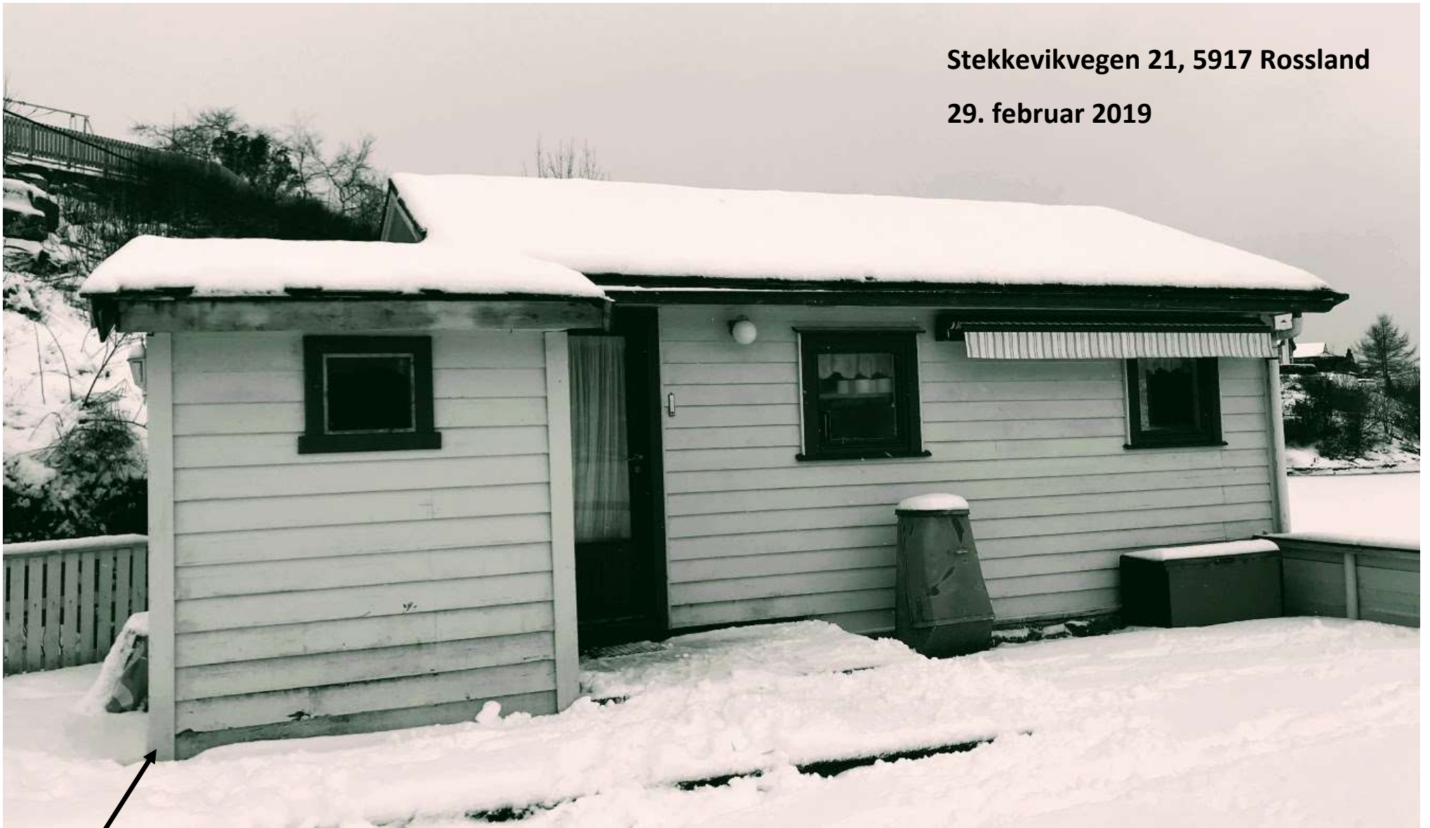
Tilbygget er i veldig dårlig forfatning og må rives.
