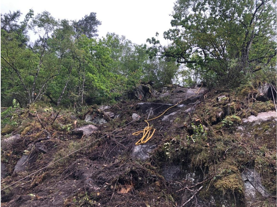
Bilde 2. Skredløpet er rensket, men det står igjen flere sprekkeavløste bergpartier og -blokker som må sikres med bolter eller tas ned med lufttrykkspute, spett eller ved sprenging.
