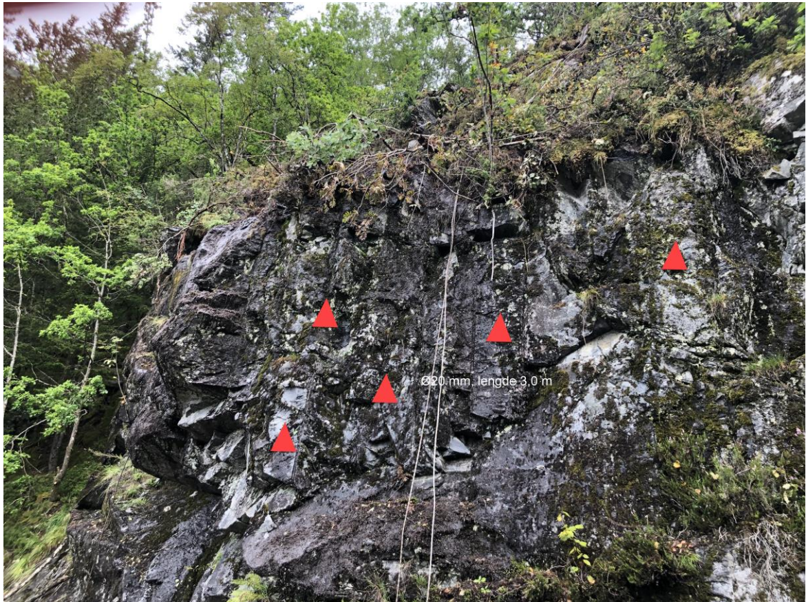
Bilde 5. Ustabil bergparti/kile i vegskjæring som må sikres med Ø20 mm bolter med lengde 3,0 m.
