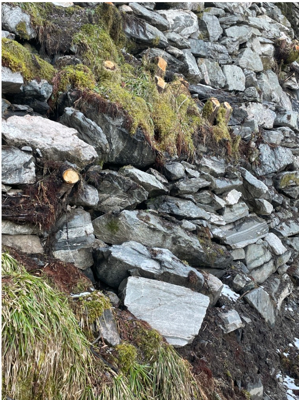
Biletet viser området der det har vore noko rørsle i murverket.
