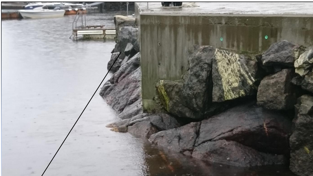
Bilde 3: Er tatt fra hjørne nordvest hos nabo og viser kaifront ut mot sjø. Bildet viser også at kaifront er uegnet for til-legging av båter. Min eiendom har grense ca. 2 meter fra hjørne mot flytebryggen opppe til venstre til hjørne (bilde 1)
