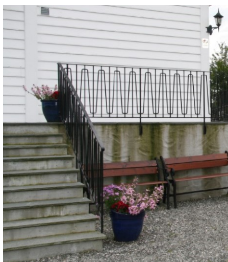
Rekkverk på Sæbø kirke. Rekkverket festes på yttersiden av terrengmur.
