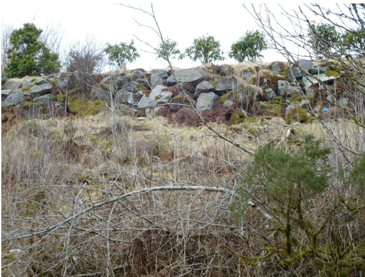
Fig.2: En uryddig og løst fundamentert tørrsteinsmur i grensen mot gbnr.: 77/35. På sikt kan det være potensiale for utfall av stein fra muren og ned på reguleringsområdet.. Bør kontrolleres med hensyn til fundamentering og stabilitet.
