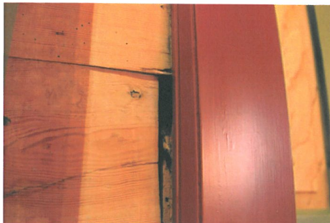
Figur 8. Horisontale forskyvninger i gavlvegg ved dør fra våpenhus
