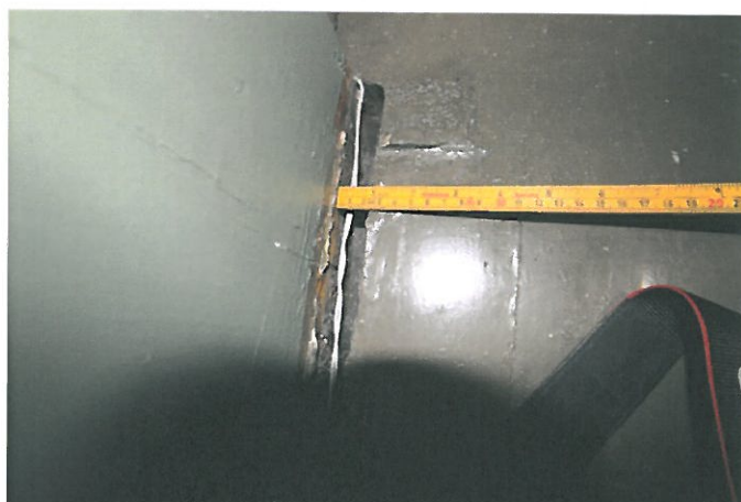
Figur 12. Sprekk på galleri
