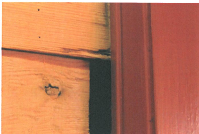
Figur 9. Horisontale forskyvninger i gavlvegg ved dør fra våpenhus
