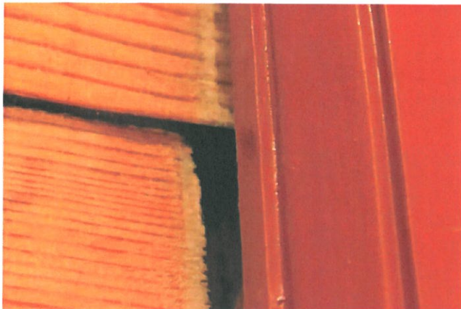
Figur 7. Horisontale forskyvninger i gavlvegg ved dør fra våpenhus
