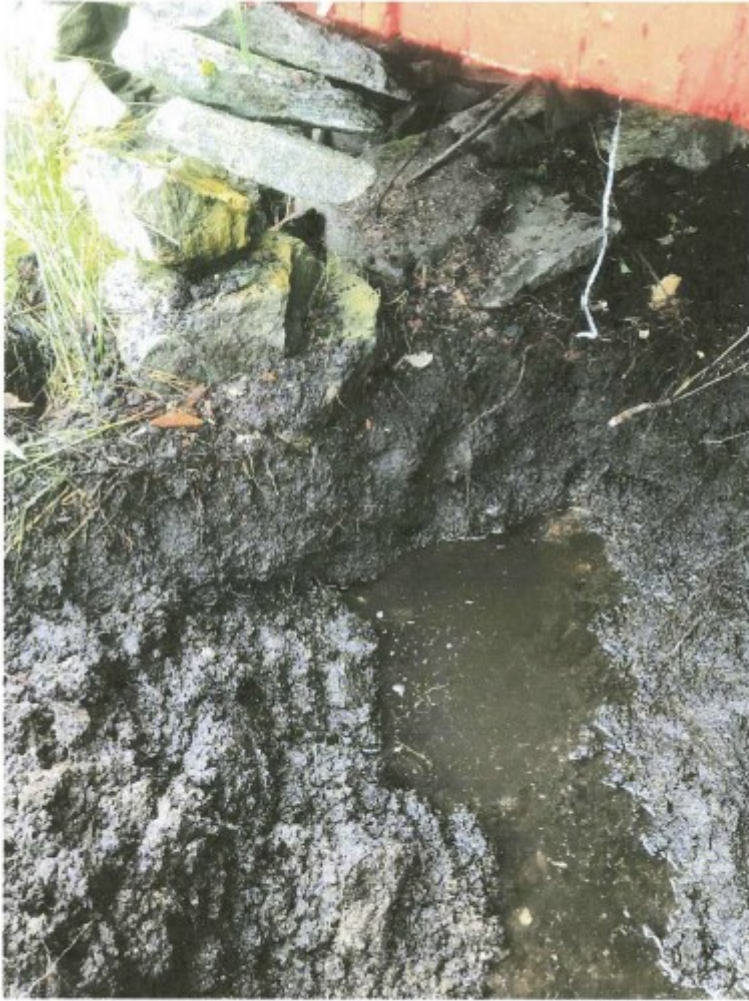
Figur 28: Vannansamling på østsiden av hytten. Denne dammen oppsto i løpet av ca 10 minutter, og viser at det er mye vann som nå har naturlig drenering under hytten.
