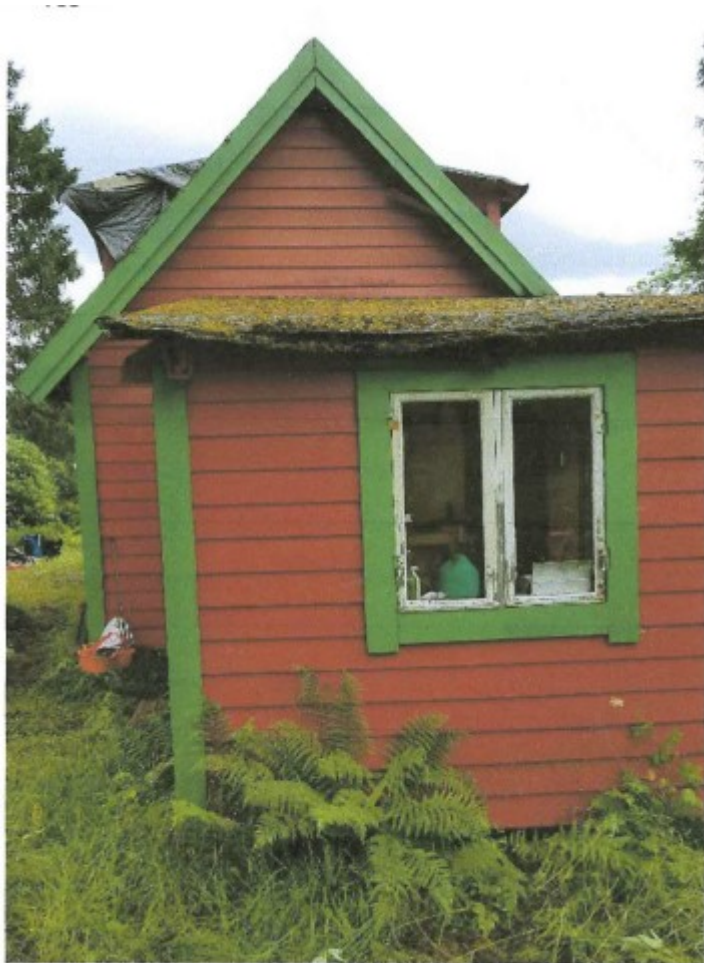
Figur 32: Tilbygg er i dårlig teknisk stand, og har en vanndam under seg.
