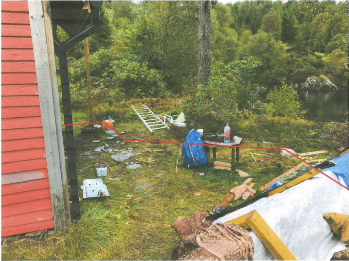
Figur 15: Område der en ønsker å lage platting. Merk spesielt at terrenget er høyere mellom plattinggrense (illustrert i rødt) og sjø.
