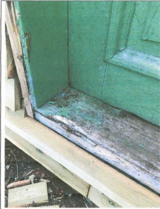
Figur 9: Inngangsdør, må byttes
