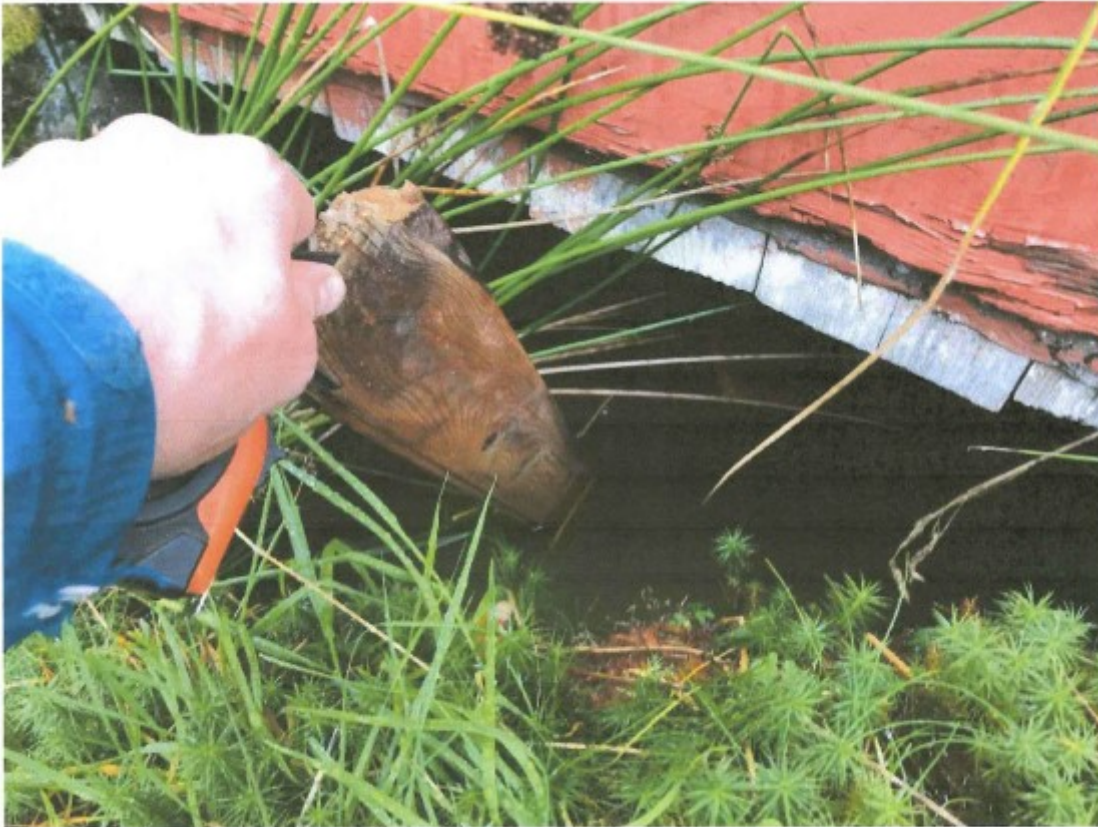
Figur 27: Bildet viser vanddammen under tilbygg. Det er ca 1 meter med vann, her forsøkt illustrert med en lang planke.
