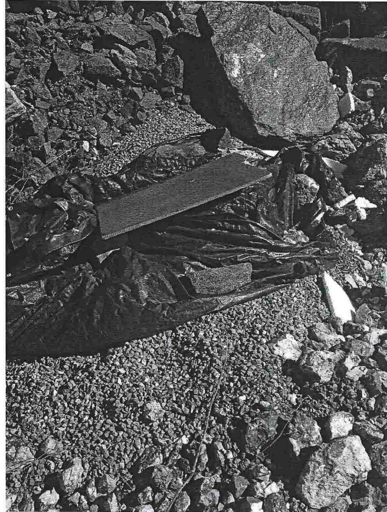
VA ledning i dagen uten frostsikring
