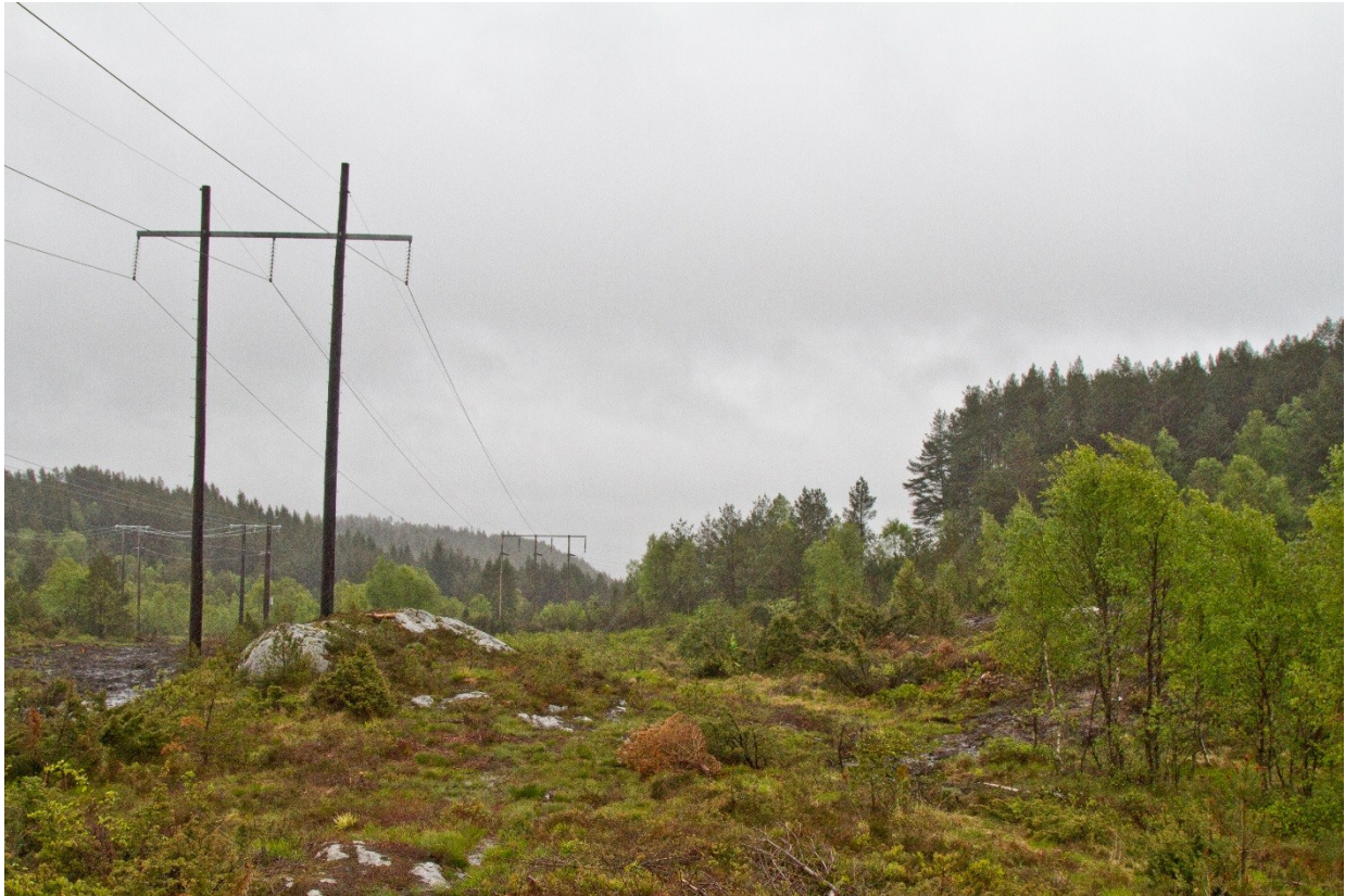
Eksisterende 132 kV kraftledning sør for stasjonsområdet. Ny kraftledningstrasé til høyre for denne. Gjensetting av vegetasjon i traséen viser at skogryddingsplanen er godt fulgt opp.
