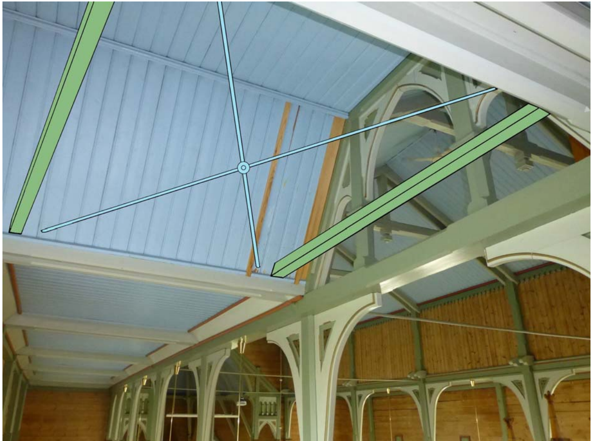
Figur 1: Manger kirke synlig stål ved takoppstikk.
